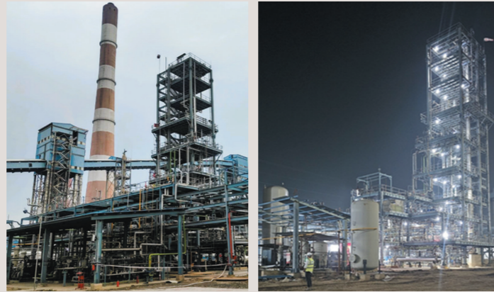
発電所内に設置されたメタノール合成実証プラント全体図
