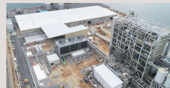
愛知県蒲郡バイオマス発電所
