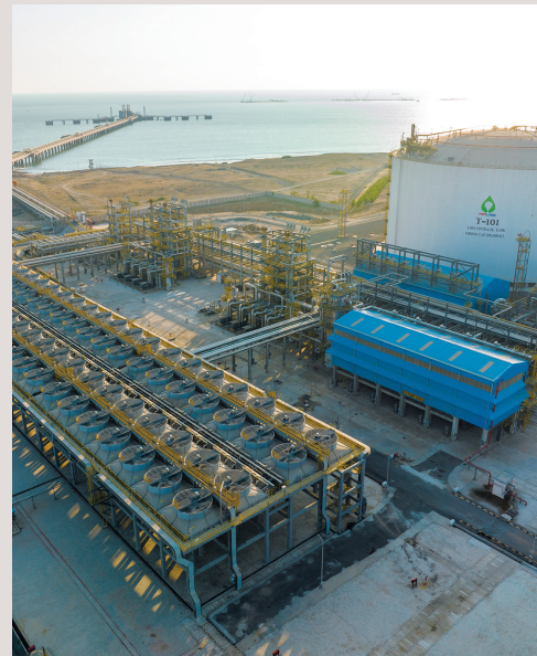
LNG再ガス化設備
