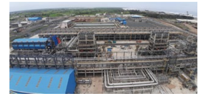
HPLNG社向けLNG再ガス化設備
