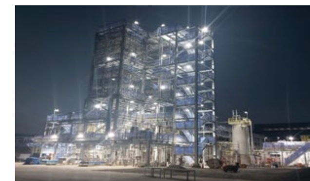
2023年完工 Dry Gasプラント
