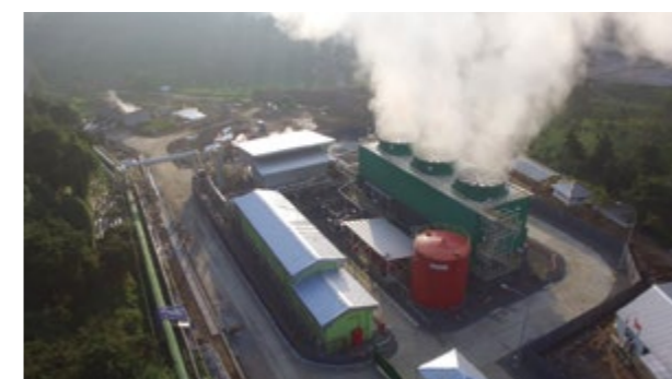
ディエン小規模地熱発電所
