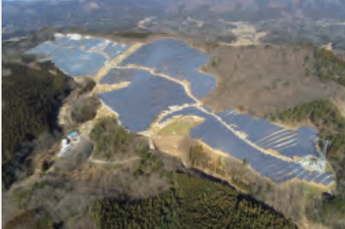
いわきメガソーラー発電所（福島県）
