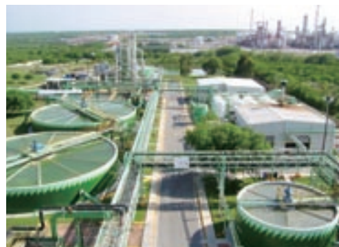
アトラテック社が建設・操業しているメキシコ国営石油公社の産業廃水処理プラント
