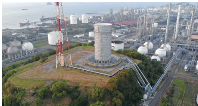
密閉式排ガス燃焼設備
