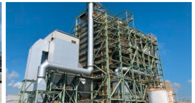
写真はいずれも大林神栖バイオマス発電所
